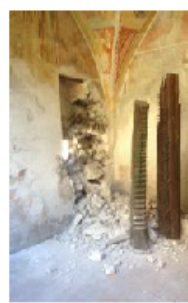
La lesione del muro della chiesa
